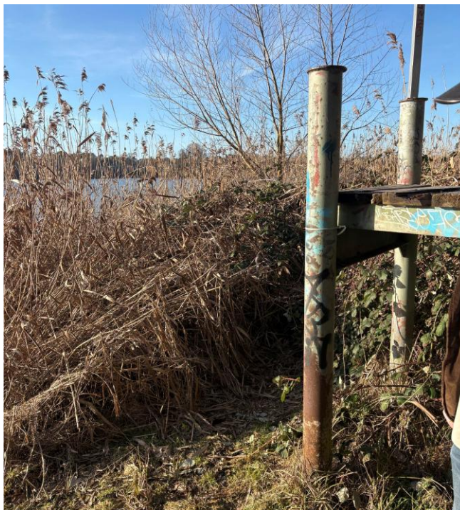
Abb. 2: Der ehemalige DLRG-Steg endet heute statt im Wasser auf trockengefallenem Grund. (Quelle: Robin Dach)
